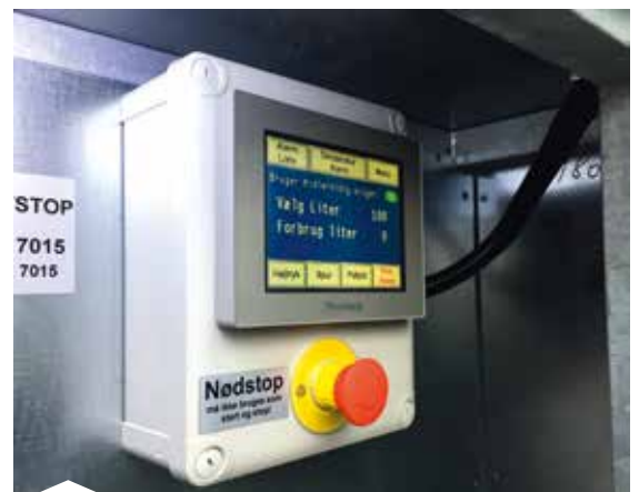
Vaskestationen måler forbruget af vand.
